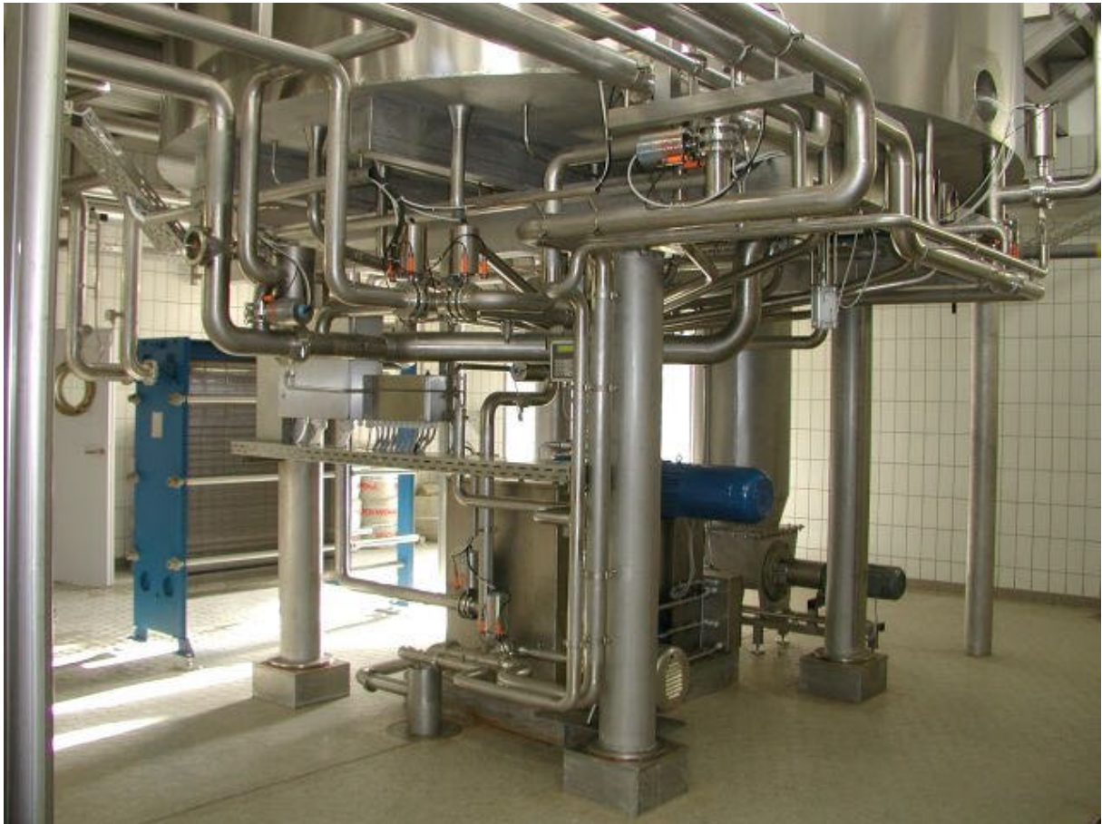
Bild 3: Läuterbottichverrohrung mit Antrieben und Läuterwürzeerhitzer
